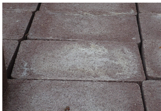
Ausblühungen an Betonpflastersteinen
